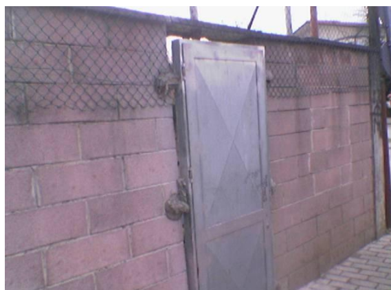
Una nuova porta a Costabissara. Un po' precaria, ma non sicuramente più bassa .....
