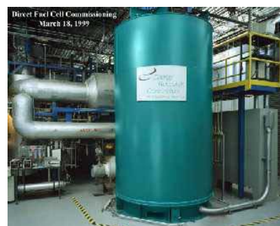
Impianto Direct Fuel Cell da 250 kW
