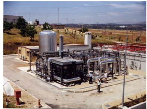
Stazione di prova PEP Iberdrola a S. Augustin de Guadalix (Madrid, E)
