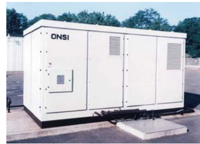
Impianto da PC25 della ONSI
