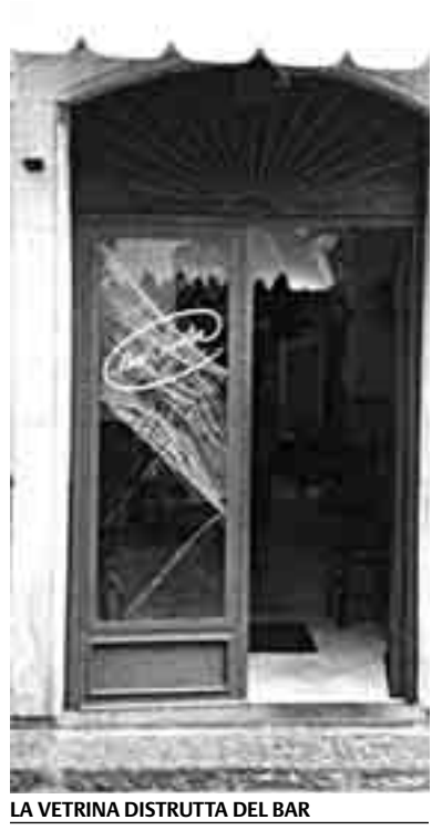
LA VETRINA DISTRUTTA DEL BAR
